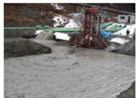
沈砂池（排砂中）
