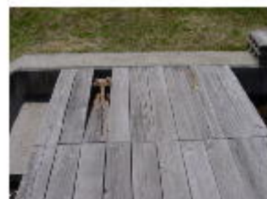
石畑水生生物観察園 (渡り橋の一部損傷)
